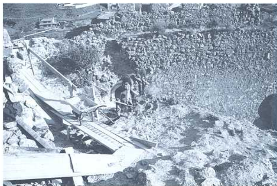
Foto 8. Vista general de los trabajos de excavación realizados en el Sector IV.
